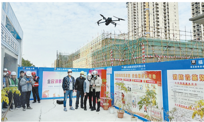
我市创新建立无人机巡查方式,明显提升工地扬尘防治管理水平。
